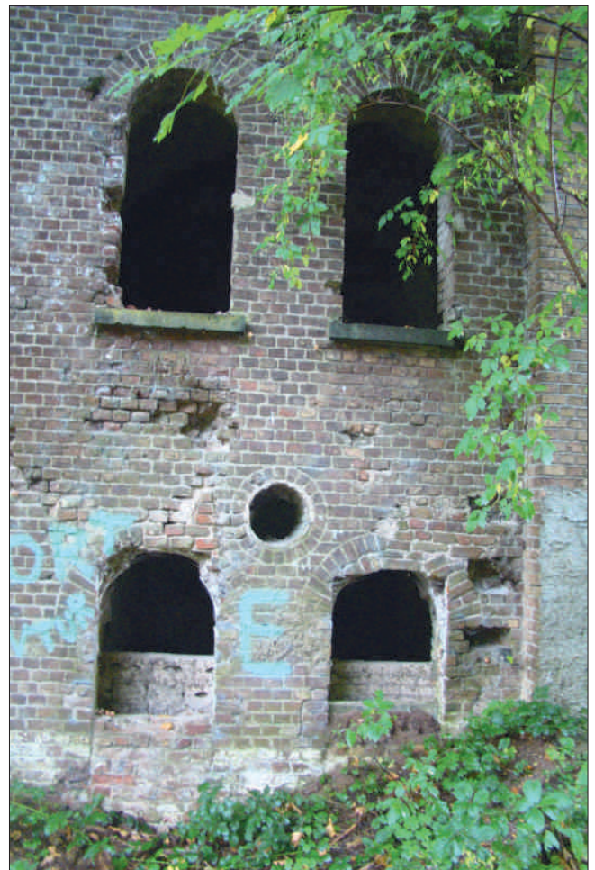
Ansatzweise zugenauerte Fenster als "tote Augen" des Baudenkmals und Schäden in der Fassade der Kehlkasernen. Die Natur erobert ihr Refugium zurück. Foto: Manfred Sabow, 2013
