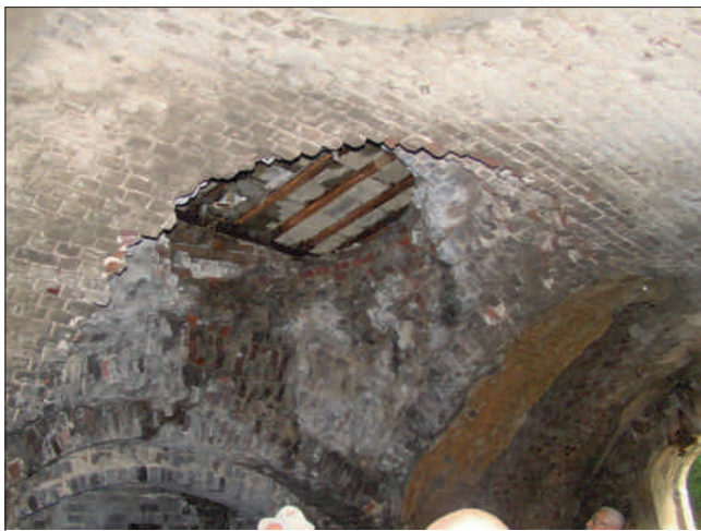
Nur dürftig gesicherte und bedeckte Öffnung in der Decke. Eine potentielle Gefahrenstelle. Foto: Manfred Sabow, 2013
